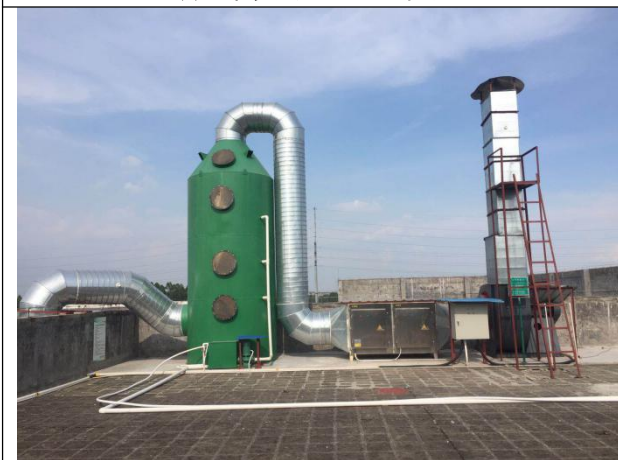
裸线车间二处理设施
