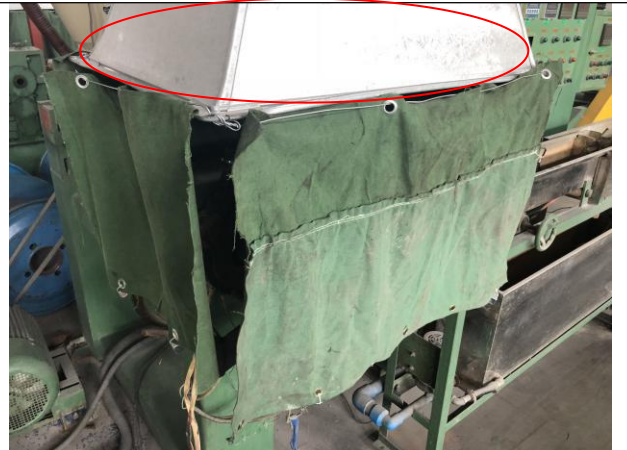
废气收集措施
