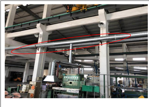
废气收集管道
