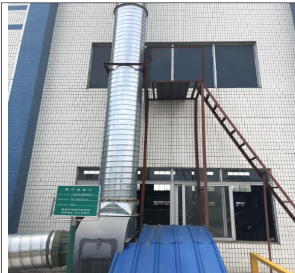
裸线车间一处理设施
